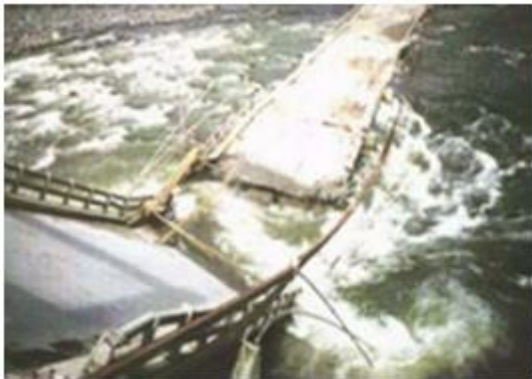
Figura 2. Colapso de puente colgante L=135m. Sismo 95
